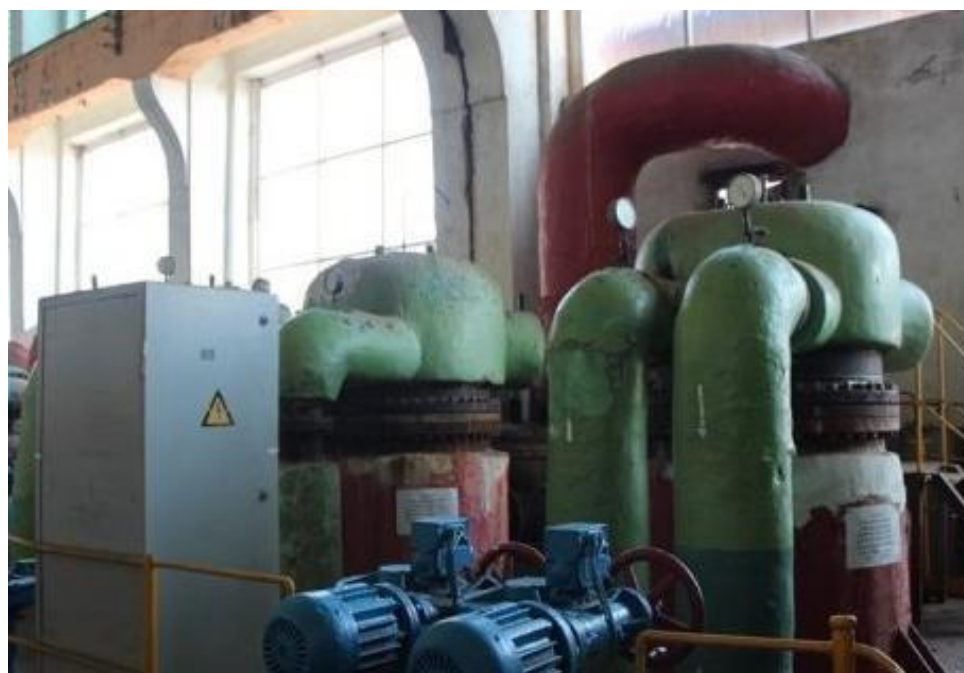
Рисунок 2 – Вид насосного оборудования
